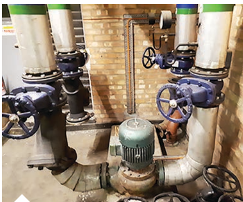
Zainstalowane zawory izolujące pompy gorącej wody centralnego ogrzewania
