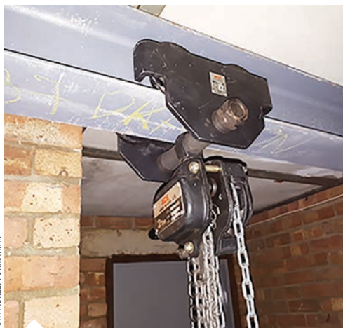
Belka transportowa z zainstalowaną wciągarką
